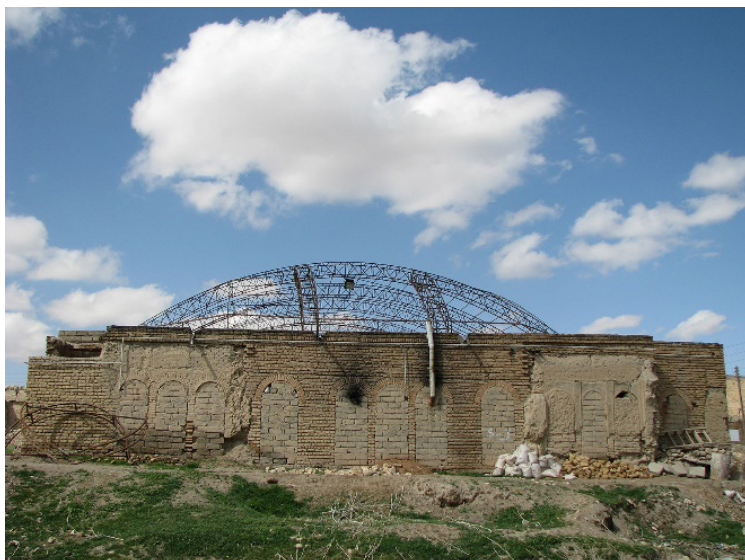
شکل ۹: محل شبستان تخریب شده جنوبی
